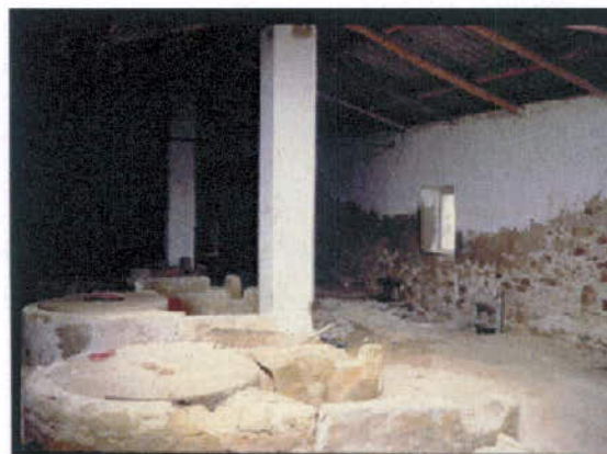
Aspectos da degradação do moinho Arquivo do PNRF
