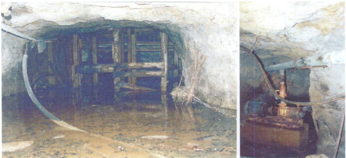
Figs. 6.17 e 6.18. A zona do poço mestre completamente inundada (à esquerda) e pormenor de uma das bombas de esgoto dos pisos inferiores, desactivada desde 1992.
