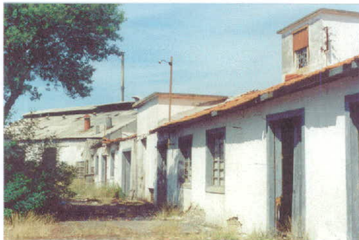
Fig. 6.7. Em primeiro plano, parte do edifício dos escritórios. As coberturas já muito danificadas, ruíram durante o inverno de 2000/2001.
